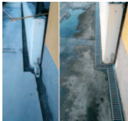
Canal de recollida d'aigua a la plaça del carrer Balmes
